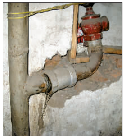
被冻裂的自来水管。
