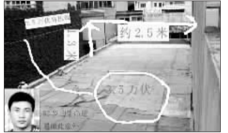
高压线离房顶很近。
