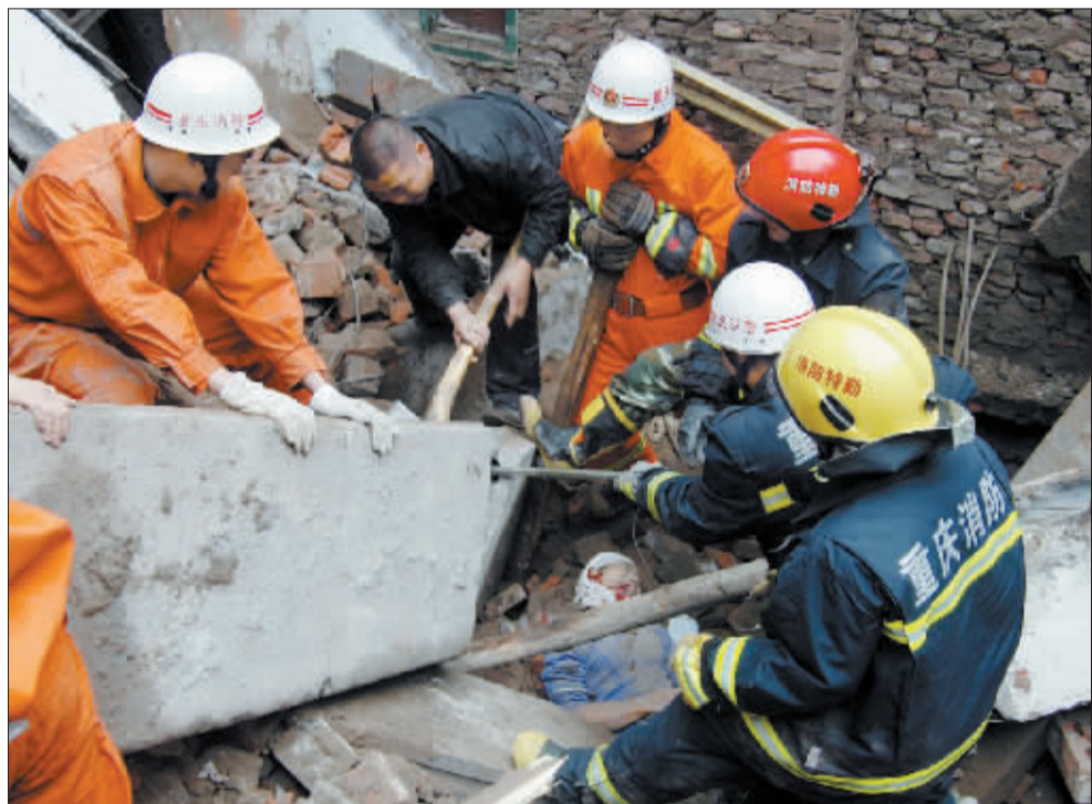
重庆一施工楼房垮塌 1人死亡14人受伤
