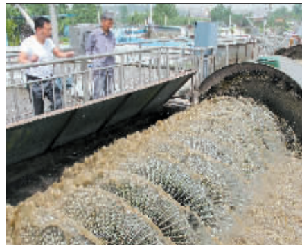
污水处理厂正在处理污水。
