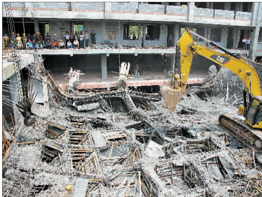
坍塌现场,工作人员正在进行施救。
