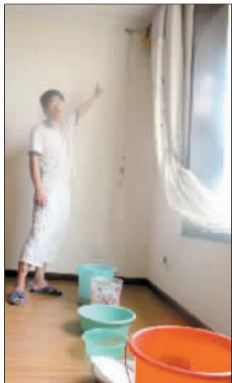
高先生家漏雨严重。
