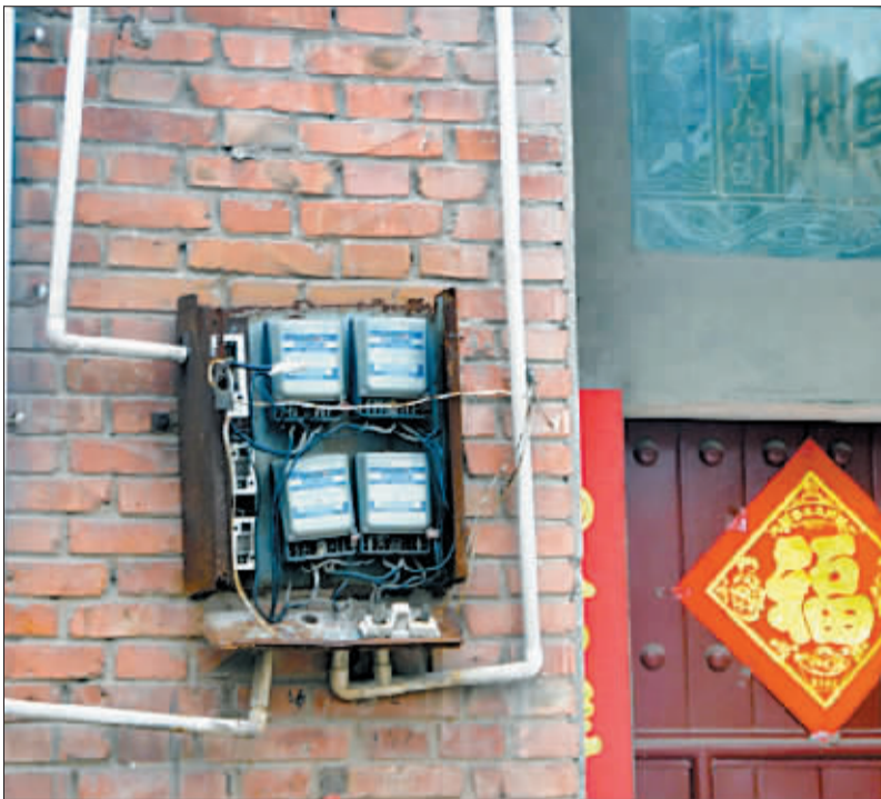
电表保护箱的外壳已被腐蚀，电表几乎完全裸露在外。
