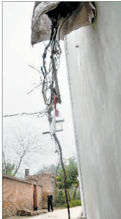
电线竟用木棍支撑着，很不安全。
