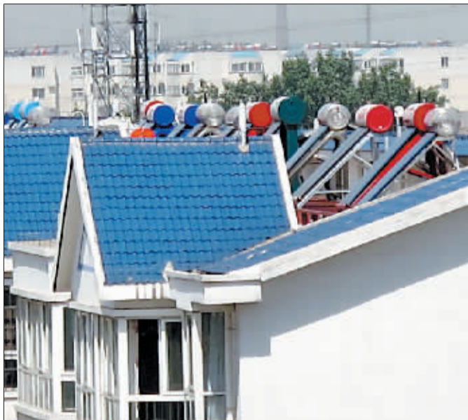
安装在楼顶的太阳能热水器。
