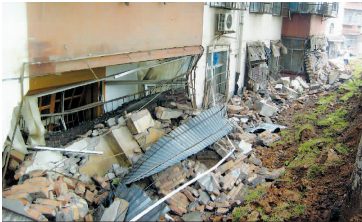
中泰花园小区内被暴雨损毁的居民住房。
