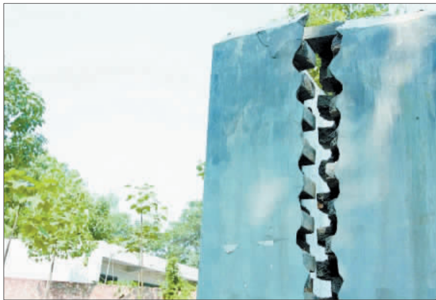
墙上裂缝能塞进拳头。
