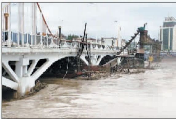
陇南一座大桥被采沙船撞坏。(新华网)
