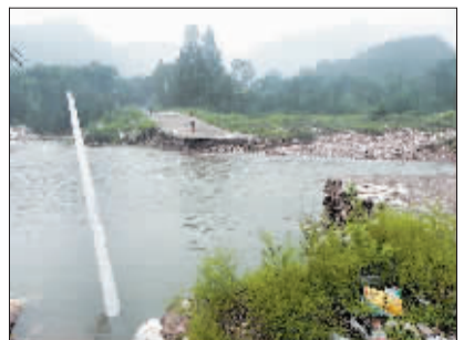
新安通往龙潭大峡谷的漫水桥坍塌。记者 赵朝军 摄
