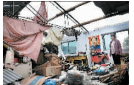
孟津县陆村一农户的屋顶被掀掉。见习记者 赵俊善 摄
