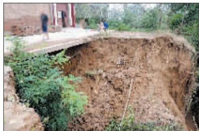
孟津县小浪底镇崔岭村出现塌方。记者 李卫超 摄
