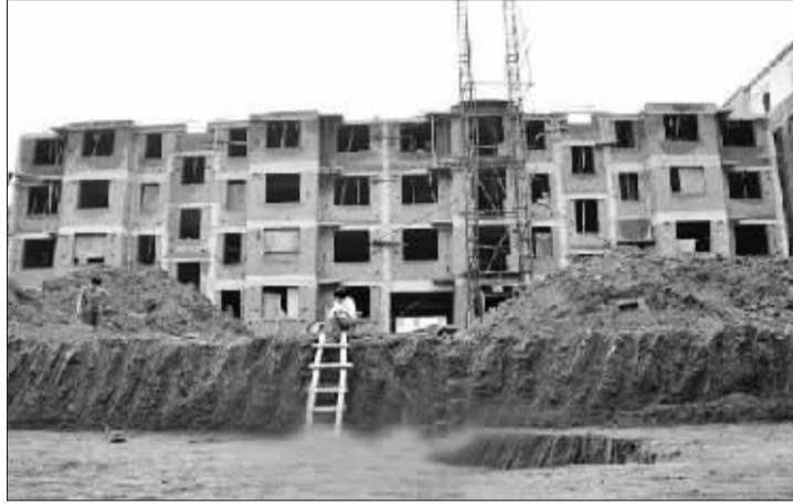
这栋已建了4层的楼房离蔡国故城墙不足50米。
