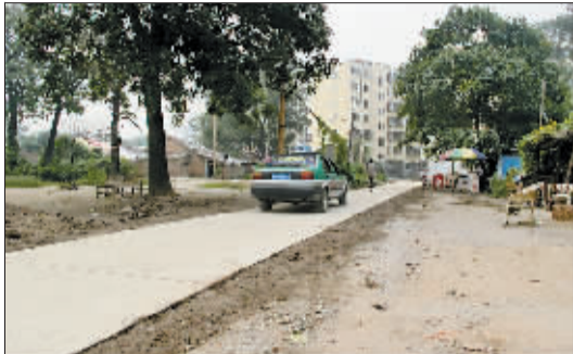
成的水泥路。 南昌路办事处六冶家属院已修
