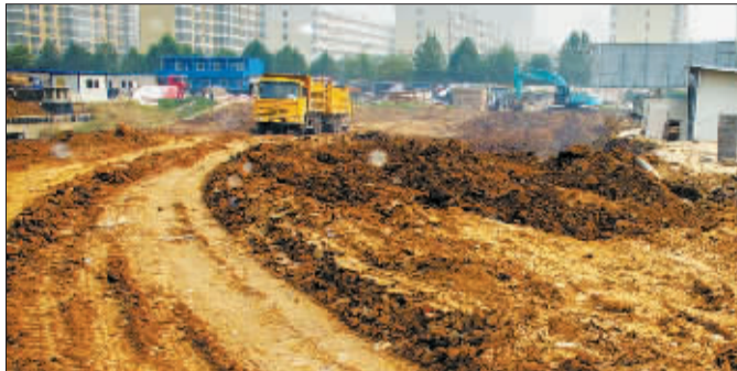
正在施工的工地是造成沿路抛洒的源头。
