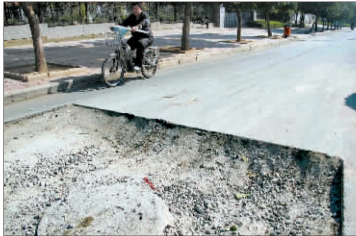
这个大坑占据了慢车道的大部分。
