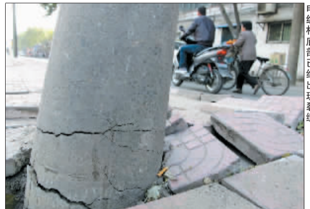
电线杆底部已经出现裂缝。
