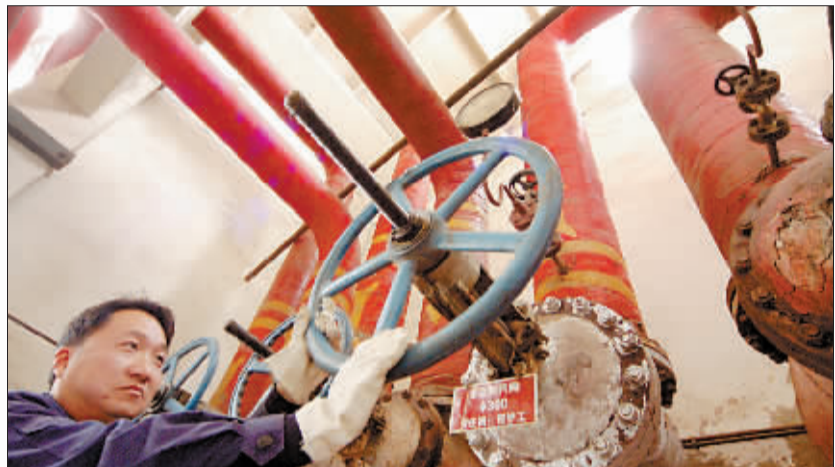
在市热力公司九都路集中供热中心,工作人员开启热力管网供热阀门。
