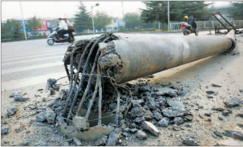
电线杆被撞倒，横在路口。
