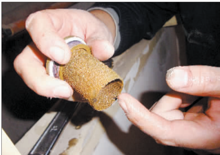
除污器过滤网上满是杂质。
