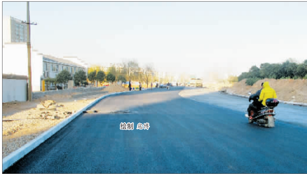
滨河北路丽新路至珠江路段的沥青摊铺工作已基本完成。
