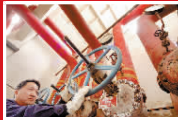
2010年11月15日凌晨,市热力公司九都路集中供热中心工作人员开启供热阀门。
