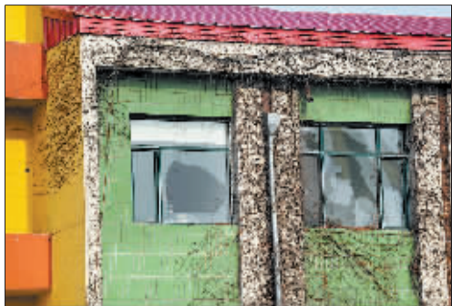
厂区外的一处楼房玻璃被冲击波震碎。
