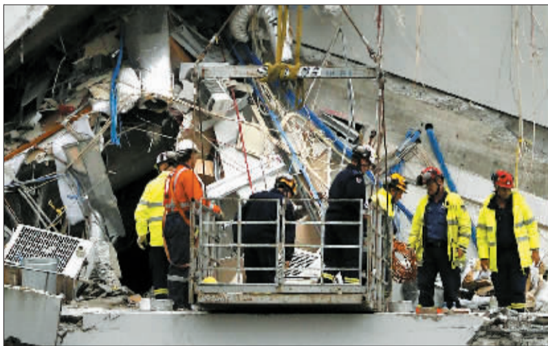
救援人员在一栋大楼内搜寻幸存者。
