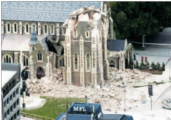
震后,基督城大教堂尖塔被毁,昔日胜景不复存在。(新华社)
