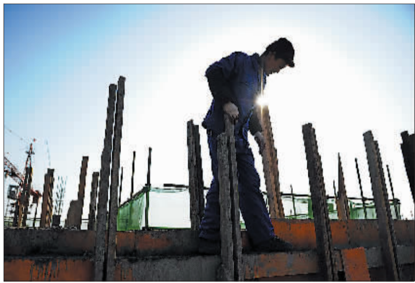
在合肥廉租房项目“永和公寓”二期工地,一名工人正在施工(1月12日摄)。(新华社发)
