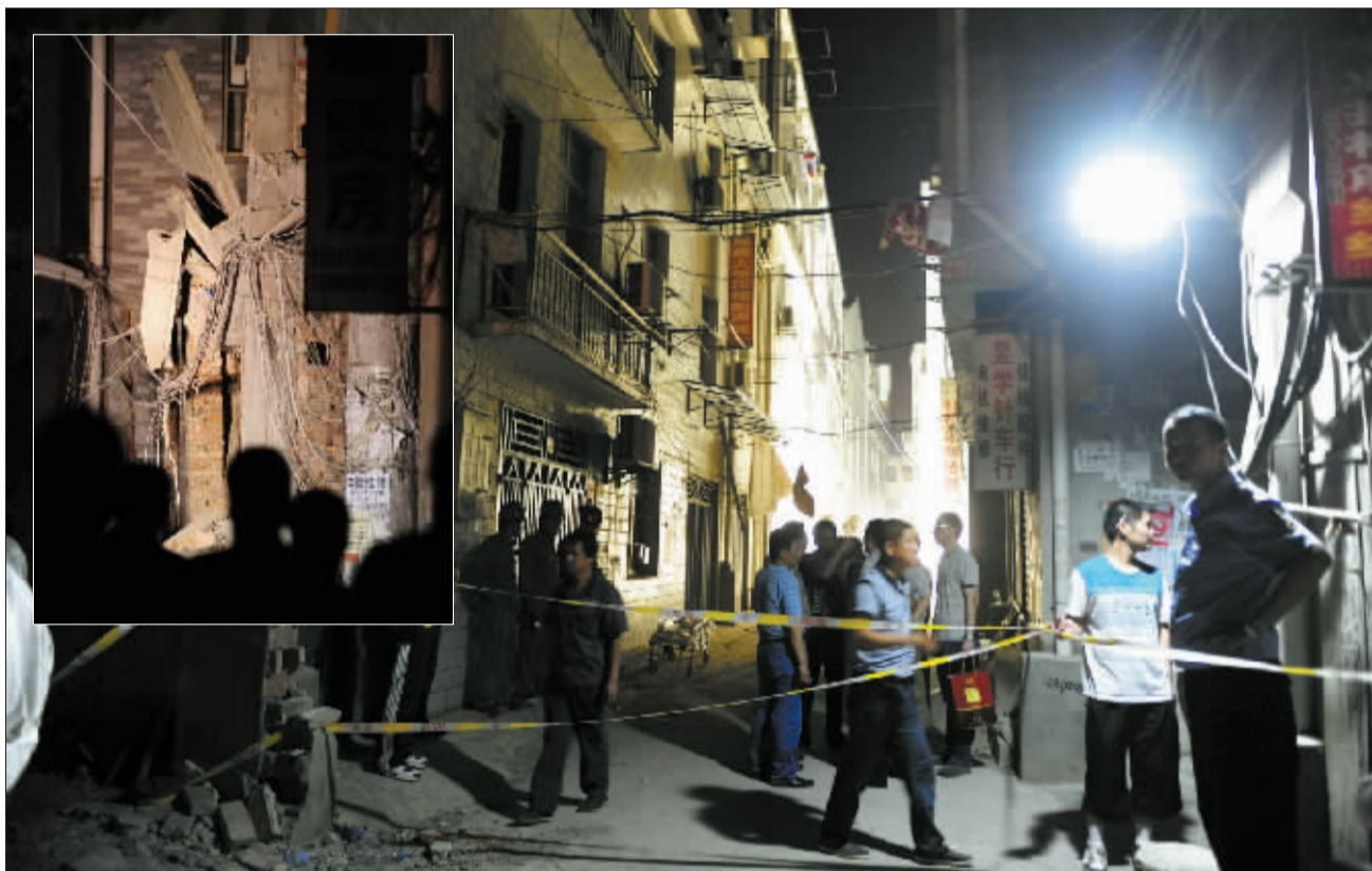
武汉在建6层楼垮塌,多人被埋
