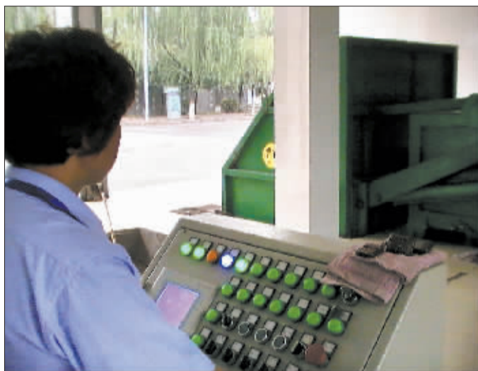
现代化的垃圾处理设备让这个垃圾中转站不再臭气熏天。
