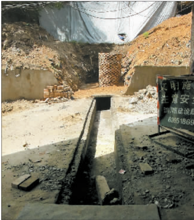
设在此处的大型雨水通算将有效拦截雨水。
