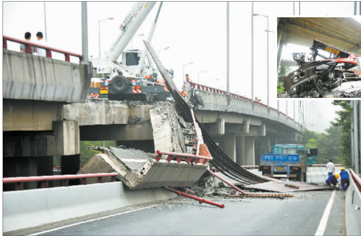
杭州钱江三桥桥面塌陷部分(大图)和坠落的重型车(小图)。新华社记者王定昶、鞠焕宗摄
