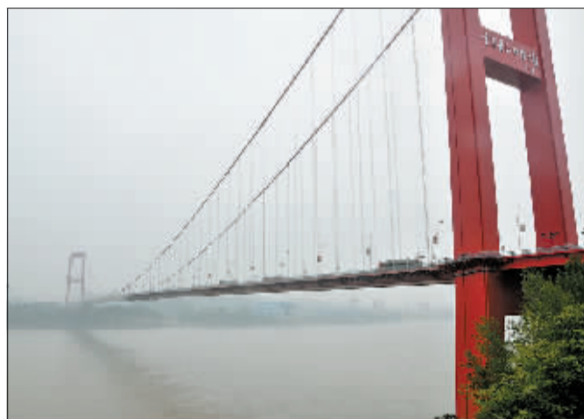
过多超重车辆通行,给宜昌长江公路大桥造成一定的安全隐患。
