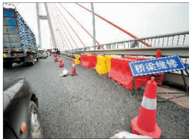
武汉白沙洲长江大桥陷入“屡坏屡修、屡修屡坏”的怪圈。
