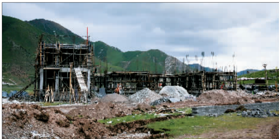
这是青海玉树藏族自治州杂多县妇幼保健院在建工地。该项目与治多县妇幼保健院在中国红十字会上公布的建筑面积和造价引起网友质疑:投资总额相同,建筑面积为何竟相差几倍? (新华社发)
