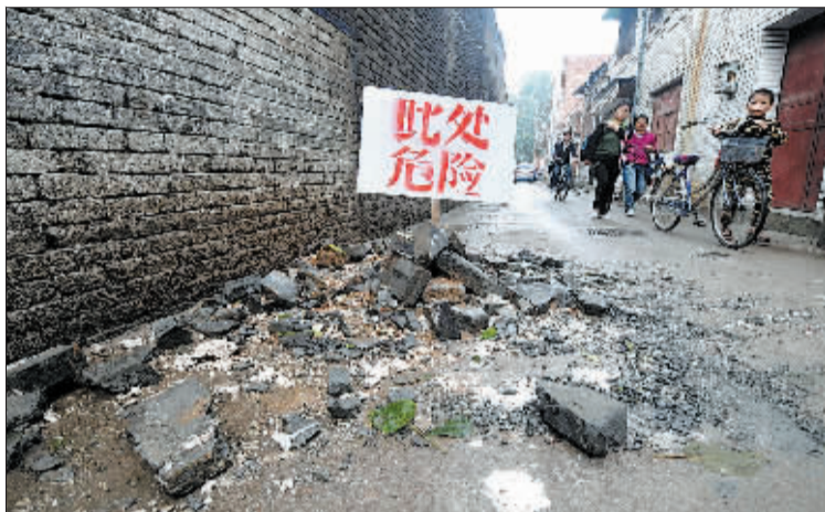
老城贴廓巷小学大门东侧围墙风化严重，连日降雨使得墙砖脱落。记者 张光辉 摄
