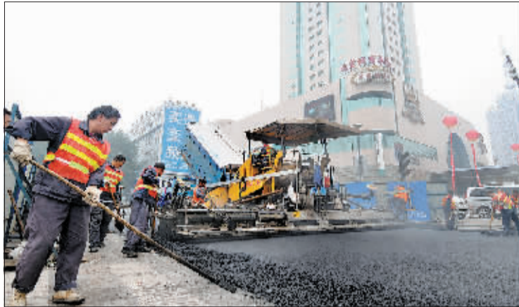
摊铺沥青。九月二十七日，凯旋路洛阳农行门前段正在施工。
