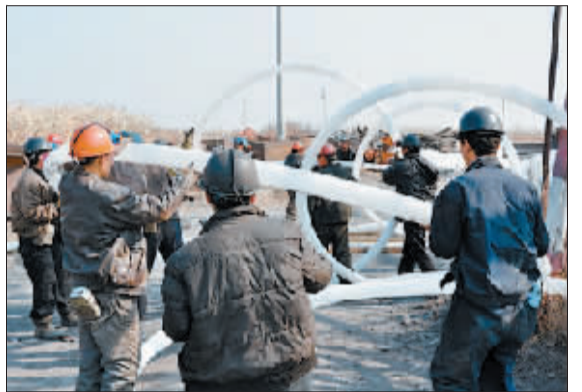
图为鸡西市鸡东县金地煤矿“10·11”透水事故救援现场。(人民网)
