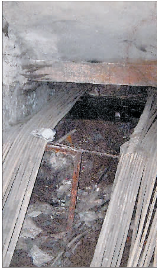
地下室脏乱不堪, 有积水。
