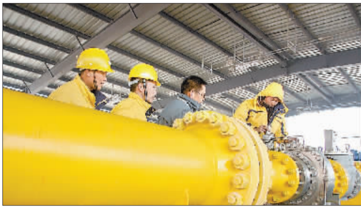
在西气东输二线入市管线小庄门站,员工正在打开天然气高压管网阀门,来自中亚的优质天然气缓缓进入市区管网。
