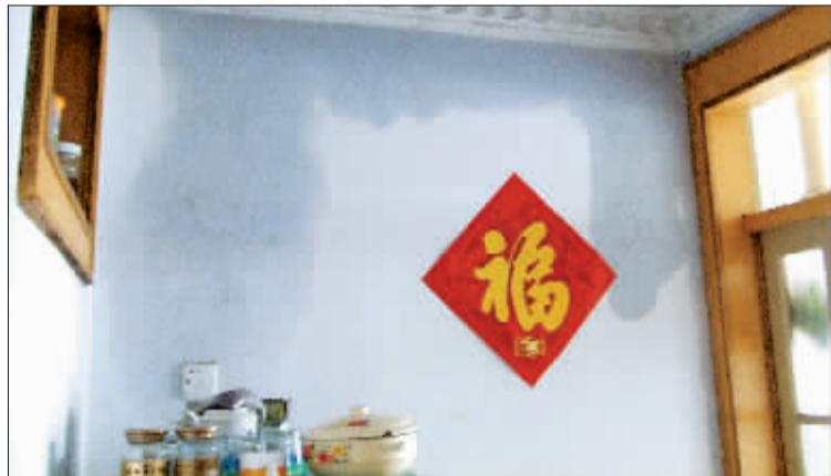
严先生家墙壁上出现多处水渍。
