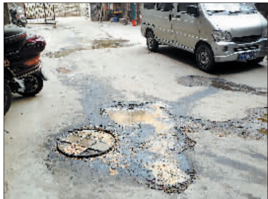
家属院里冒污水。
