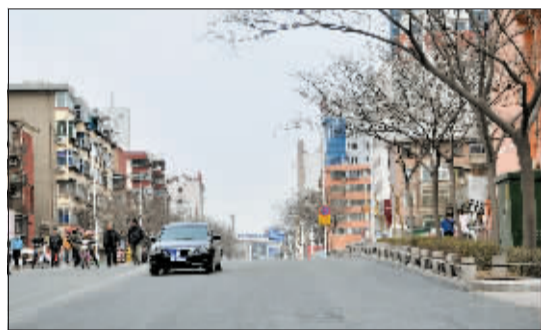
经过市政建设集团工作人员的紧张施工(上图),玻璃厂路凯旋路口段至九都路口段已恢复通行(下图)。
