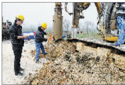
施工人员对铁路整改加固时,在路基上挖出了黑泥和黄土。
