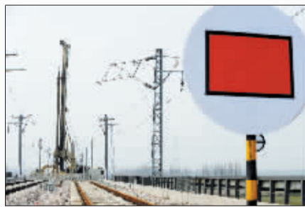
通往发生沉降路段的铁路桥上竖立起禁止通行的标志牌。
