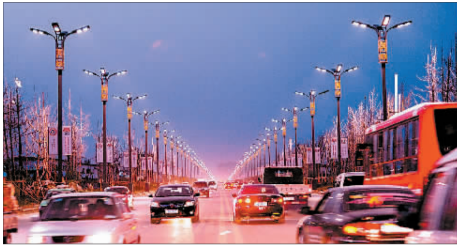
昨日,工作人员正在对龙门大道新安装的路灯进行调试。9日,龙门大道将全线亮灯。
