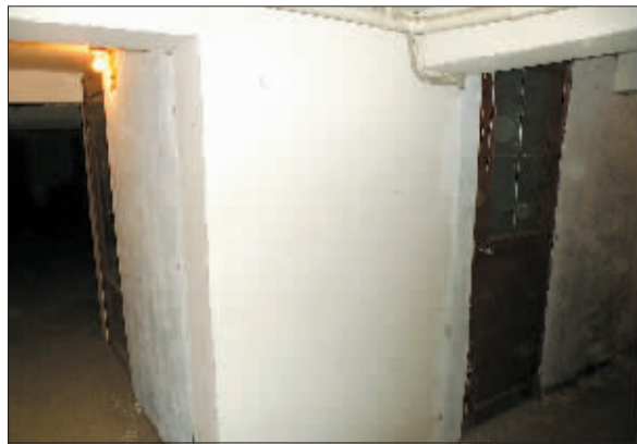
业主在储藏室私自搭建的小屋。
