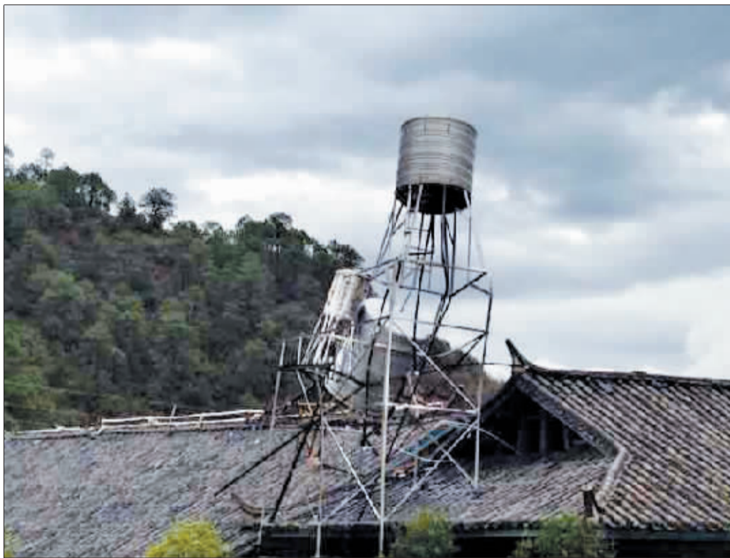
24日地震发生后，在云南省宁蒗县泥赛村，村民家屋顶水箱发生变形。(新华社发)
