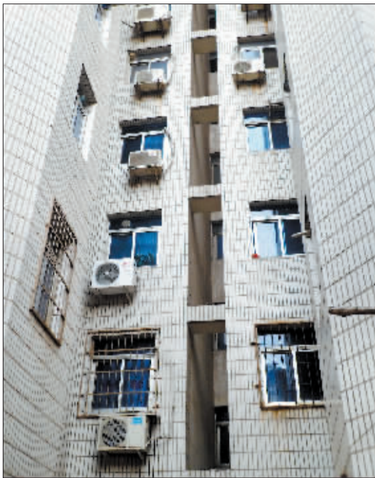
不少老旧小区楼体上没有专用的空调下水管。
