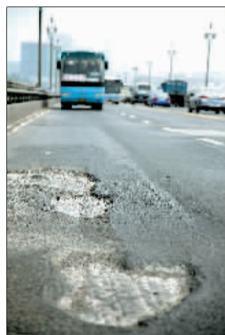
这是7月17日拍摄的南京长江大桥桥面上的坑。
