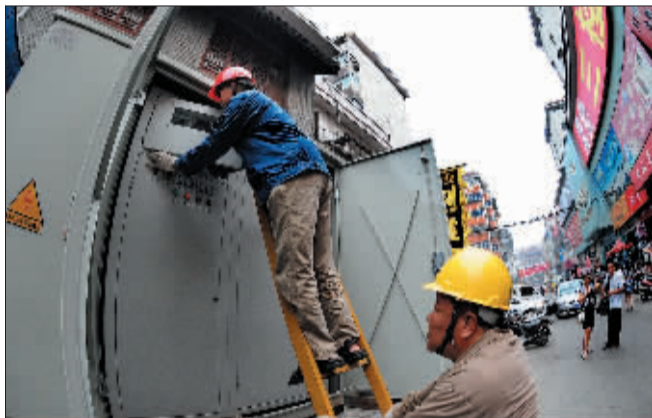
检查供电设备。
