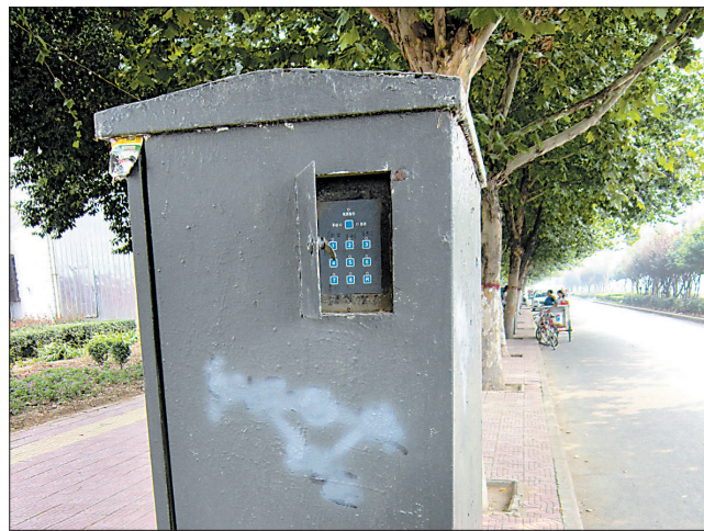
“小门大开”的交通信号灯控制箱。
