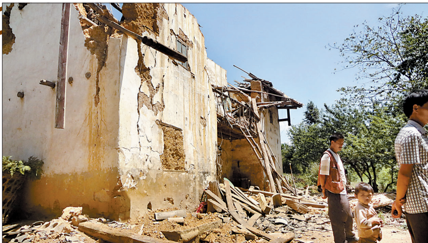
贵州省威宁县石门乡新龙村一居民房屋在地震中严重受损。
